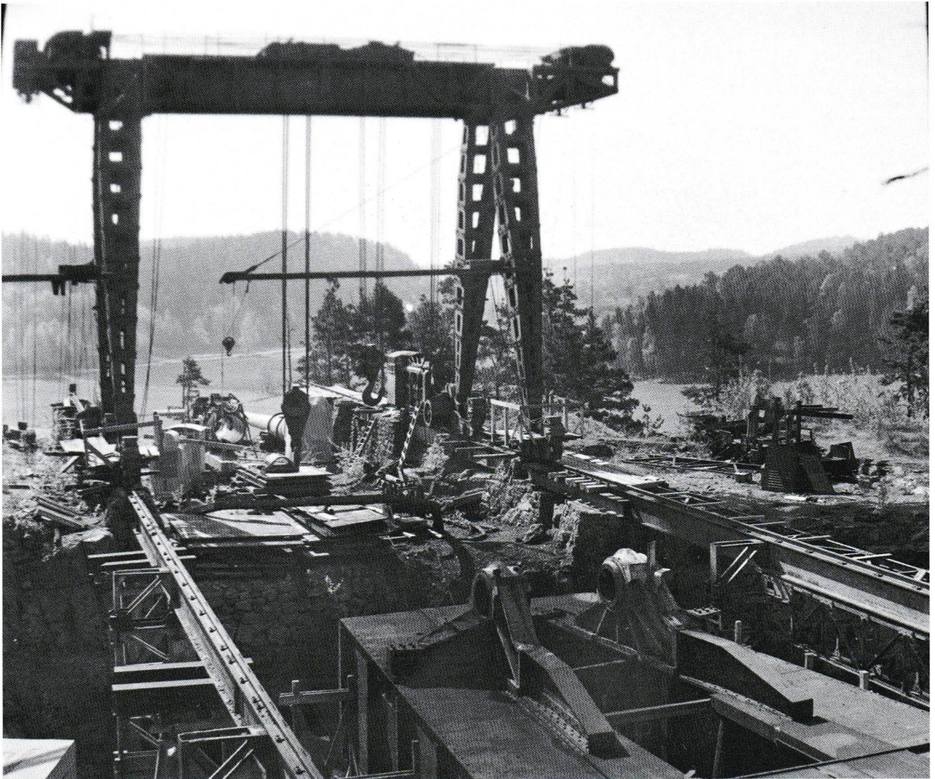
Den store traverskranen på søndre batteri ble drevet av et elektrisk tog. Foto: Rune Sorlies fotosamling
